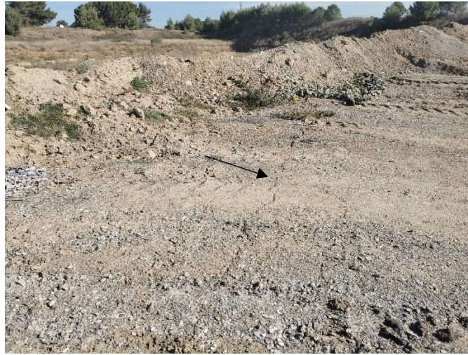
Figure 9 : Fissure de traction sur la plateforme du dépôts de déchets inertes (12/10/2021)
