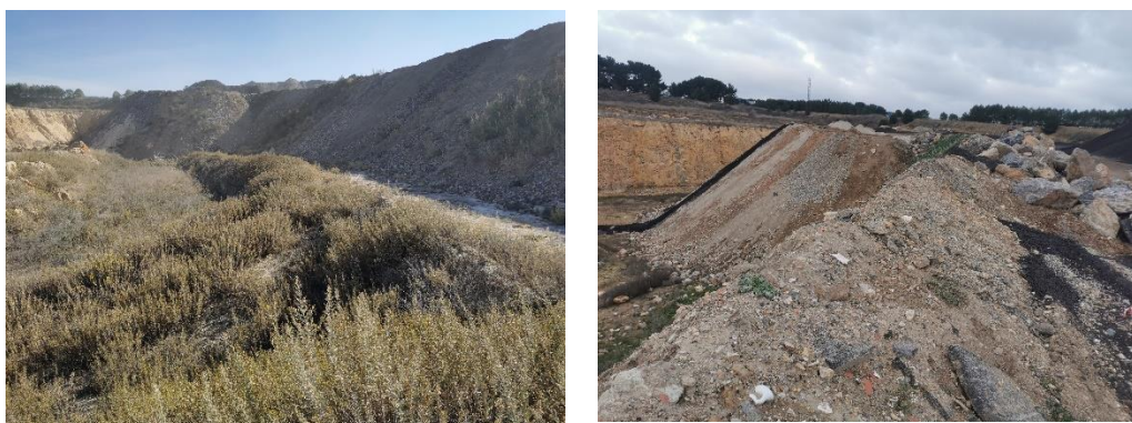
Figure 8 : Talus du dépôt de déchets inertes (16/02/2021 et 12/10/2021)
